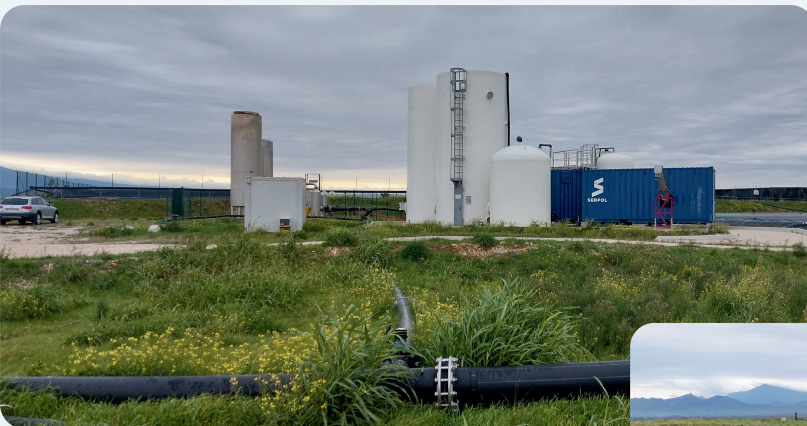
Plateforme technique (Orange 84100) Site en post exploitation
